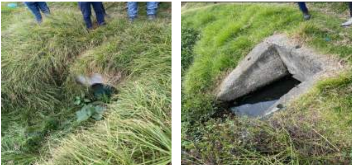
Figura 27. Descargas de aguas residuales clausurados.
